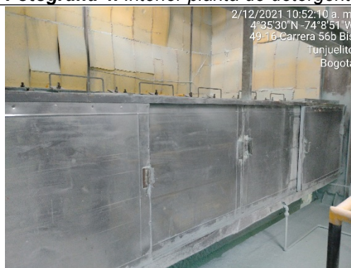
Fotografía 6. Filtro de mangas torre de secado
